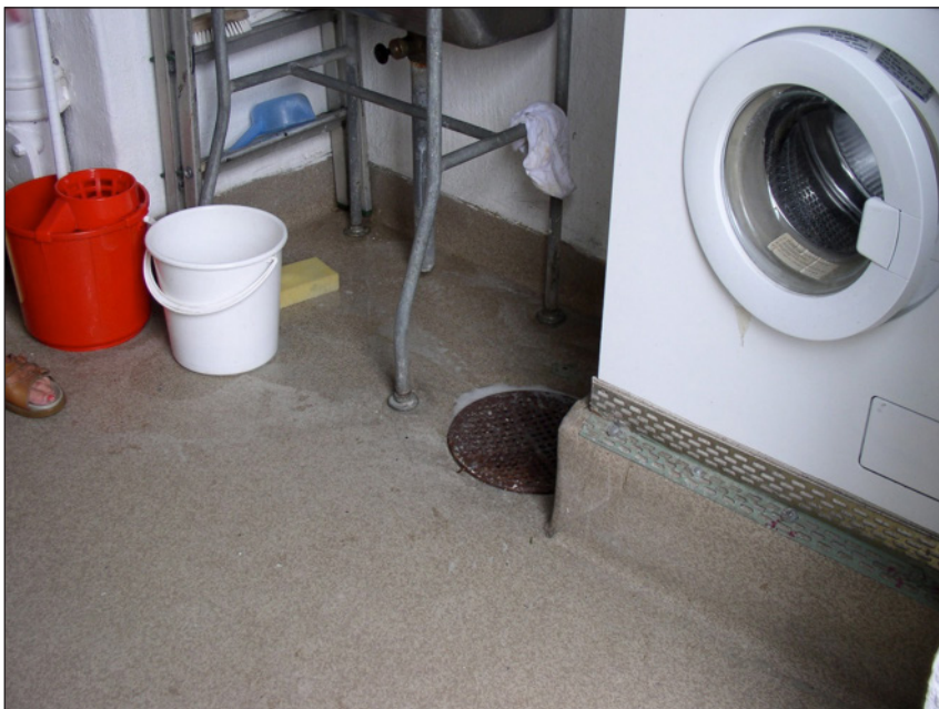
Figur 5-3 Tvättmaskin placerad upphöjd från källargolv, Växjö 2003 (Sweco).
