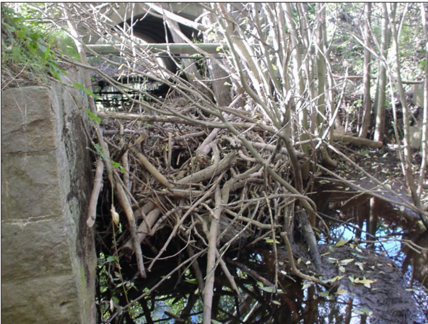
Figur 6-4 Eftersatt underhåll i större dike som används för dagvattenavledning. (Sweco 2003).
