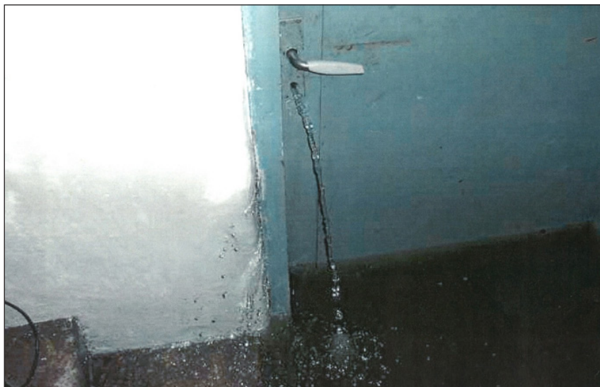
Figur 2-2 Inläckage av vatten genom källardörr. Utanför dörren stod det vatten som ytledes runnit ned i den utvändiga källartrappan med en nivå om ca 1,3 m.(Sweco 2003)
